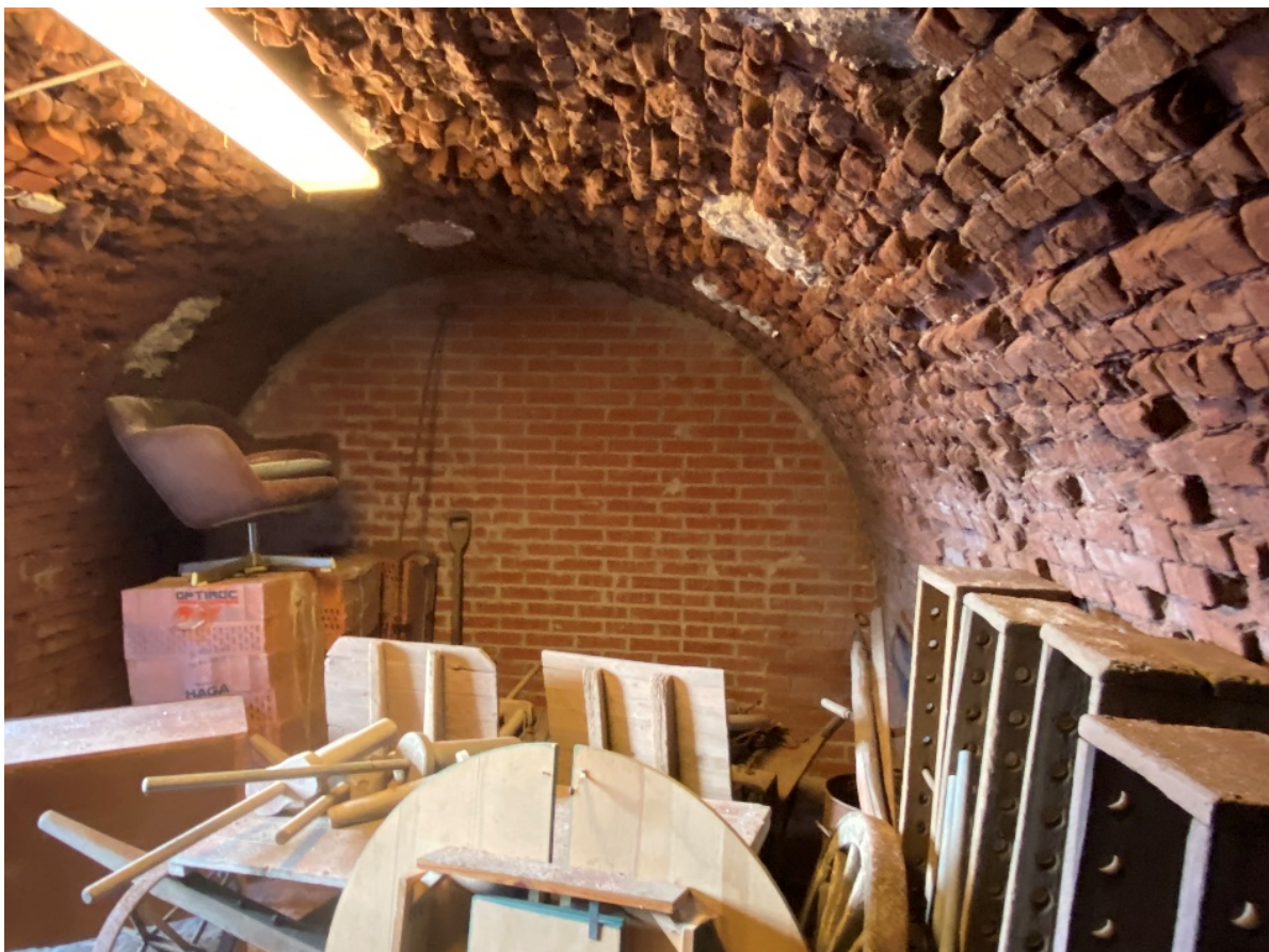
Endast en av brännugnarna finns bevarad idag. Utrymme används till förvaring. I bakgrunden syns en modern tegelmur som avgränsar utrymme mot de i övrigt igenfyllda utrymmena.
