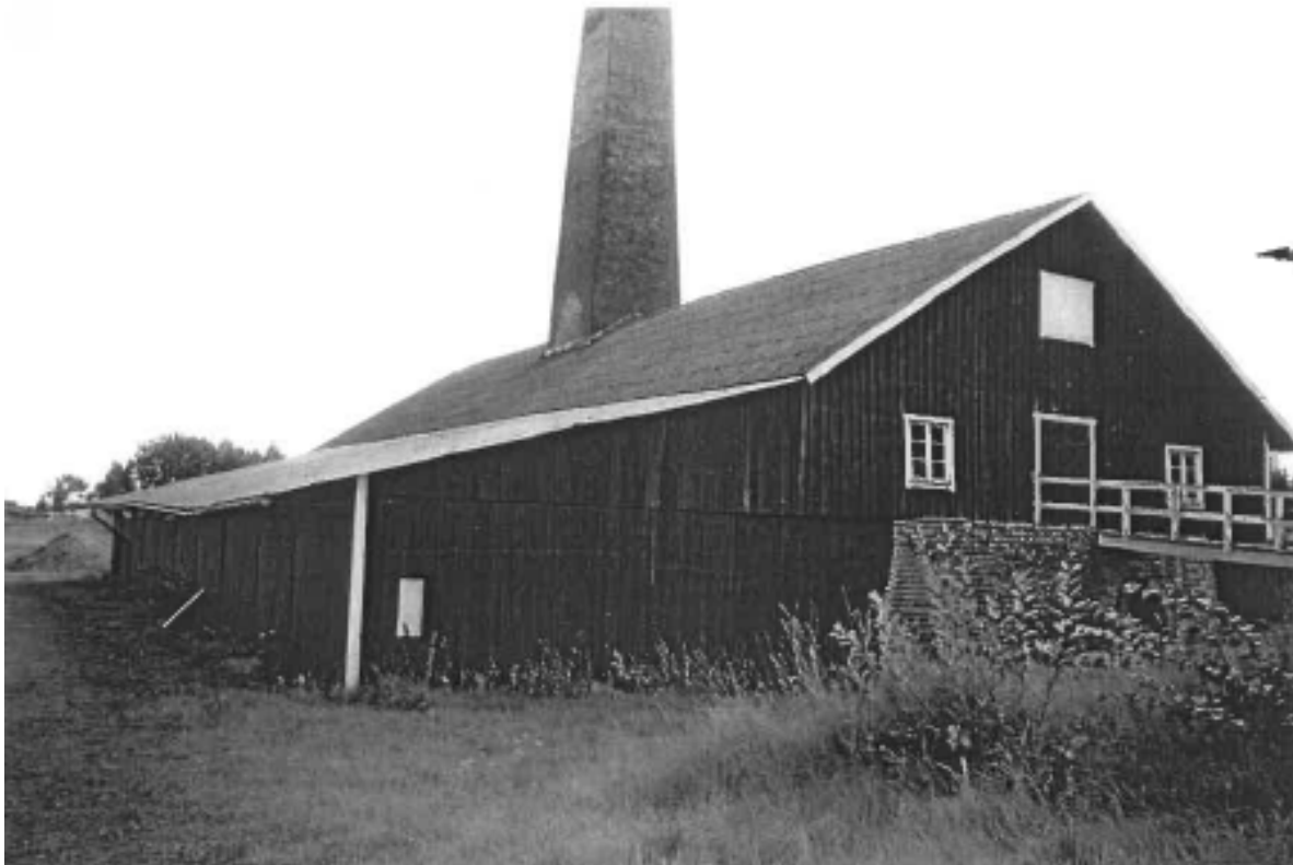
Foto från den fotodokumentation som genomfördes innan ombyggnaden, här syns den tillbyggnad som tidigare fanns uppfört längs den norra fasaden (Forsvik år 2000).
